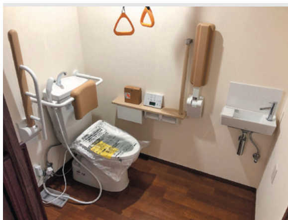
トイレには、カテテル洗浄用水栓、着衣着脱用吊皮、便座乗り移りよう手摺、体勢安定用手摺、段差解消、開口幅拡張を行った。
